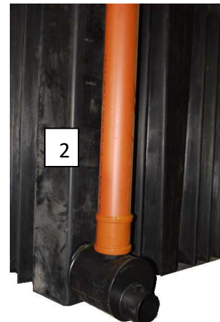
Probenahmeeinrichtung mit Rohr DN 150
